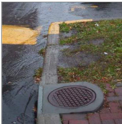
Les réseaux d'égout ont été conçus principalement pour recevoir à la fois les eaux sanitaires et les eaux pluviales Photo : N. Bédard
